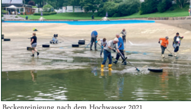
Beckenreinigung nach dem Hochwasser 2021
