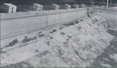
Tiefe Löcher, undichte Stellen, unterspülter Beton 1996
